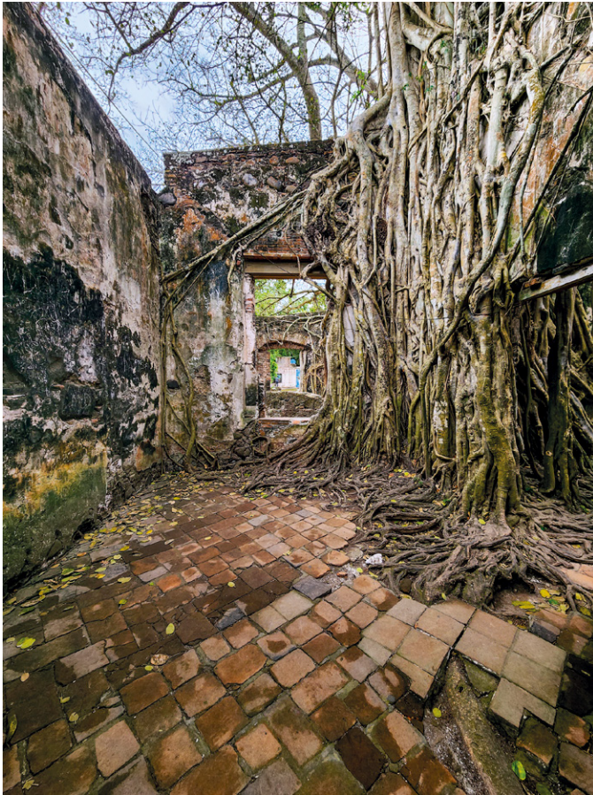
Estructura arquitectónica de la Casa de Hernán Cortés deteriorada por vegetación Municipio de La Antigua Veracruz, Veracruz, México, 2023
