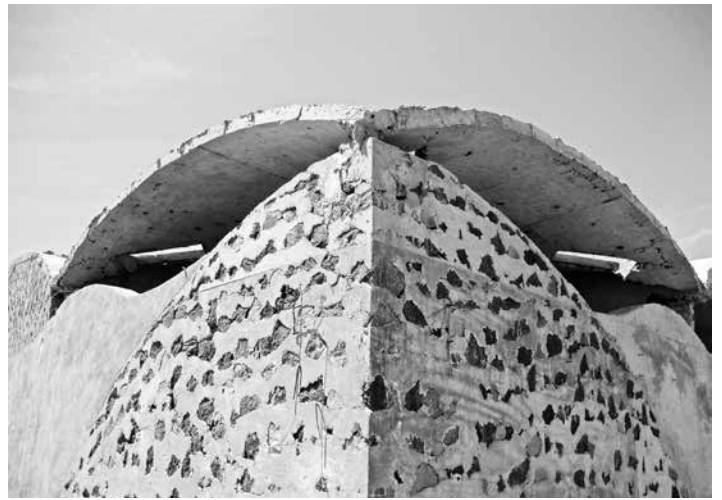
Figura 24. Muros de piedra que proporcionan resistencia al cortante. Proyecto y edificación: Mario Larrondo, Isaac López y Jaell Durán. Casa en Tlayacapan, Morelos. Fuente: Archivo de Jaell Durán e Isaac López.
